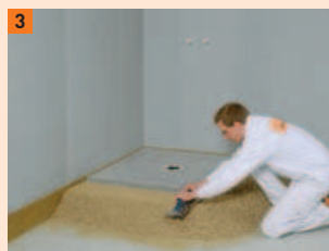
3 Variante 1a suite : Créer ensuite une digue de 20 cm de large autour du receveur en s'alignant sur la battue de celui-ci. La digue donne la hauteur du receveur. La digue donne la hauteur du receveur
